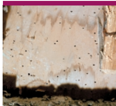
Tupajumin lentoreikiä rakenteessa.
