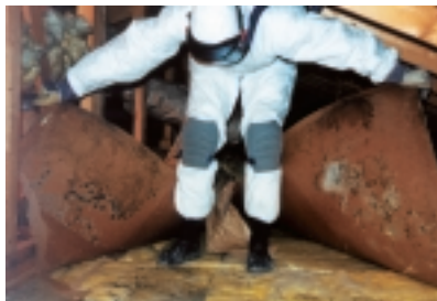
Homevaurioita lämpöeristeissä ja kuitulevyissä.
